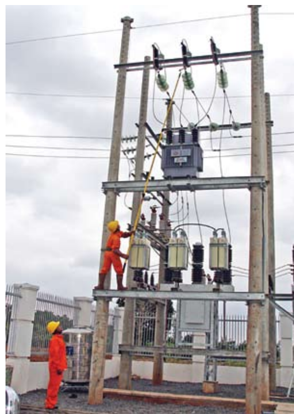
Công nhân Điện lực Đắk Lắk đang thao tác đóng điện trạm 35kV phục vụ khách hàng (tháng 1/2007)
